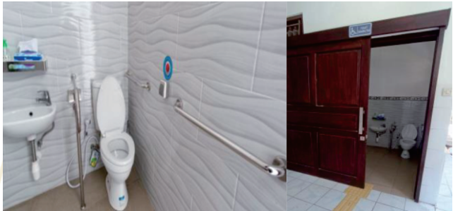
Gambar : Toilet disabilitas pada Pengadilan Negeri Singaraja
